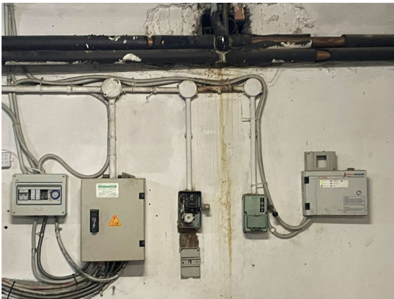
Εικόνα 1(Καλώδια πρόχειρα στερεωμένα, ασφαλειοδιακόπτης χωρίς καπάκι)
