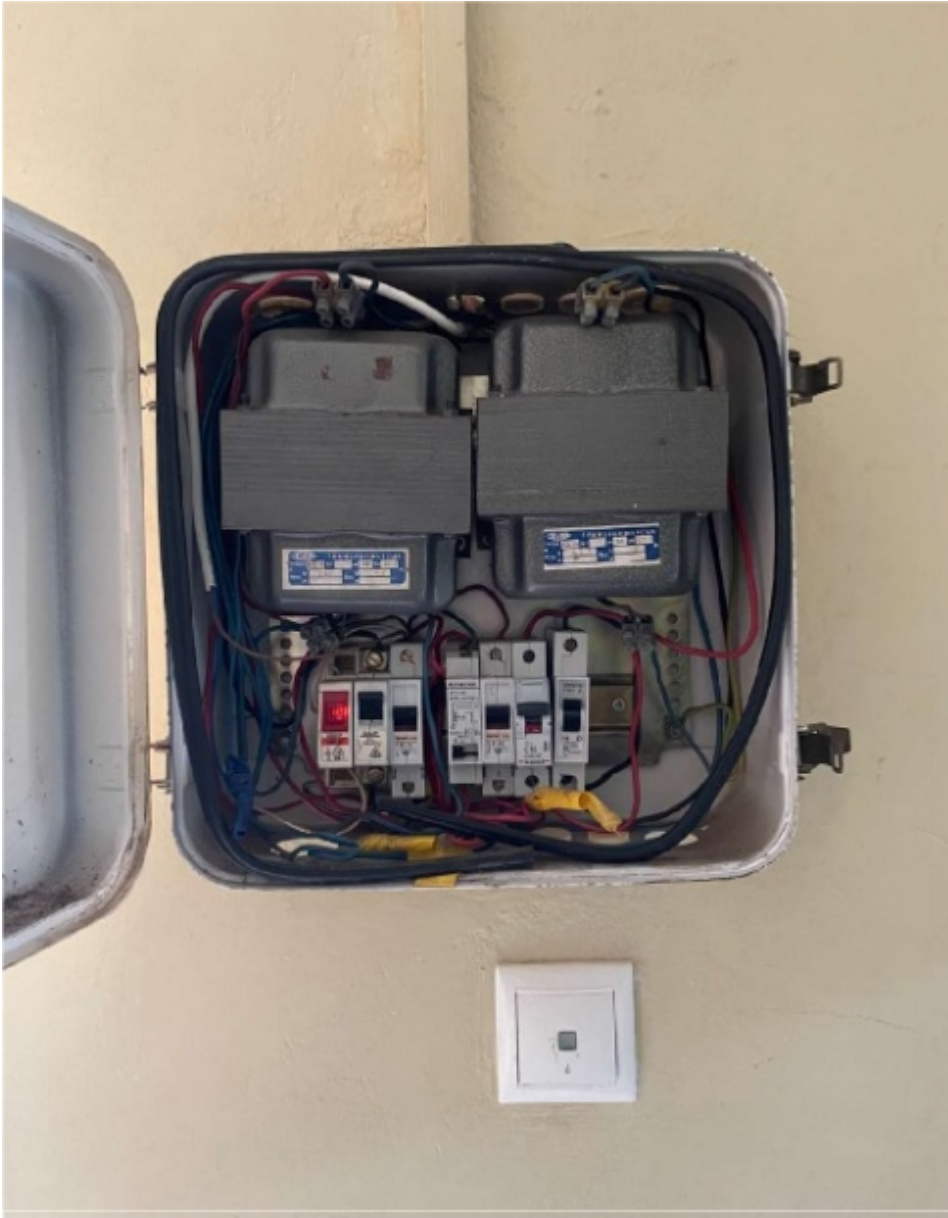
Εικόνα 17(Ηλεκτρικός πίνακας εξωτερικού φωτισμού)
