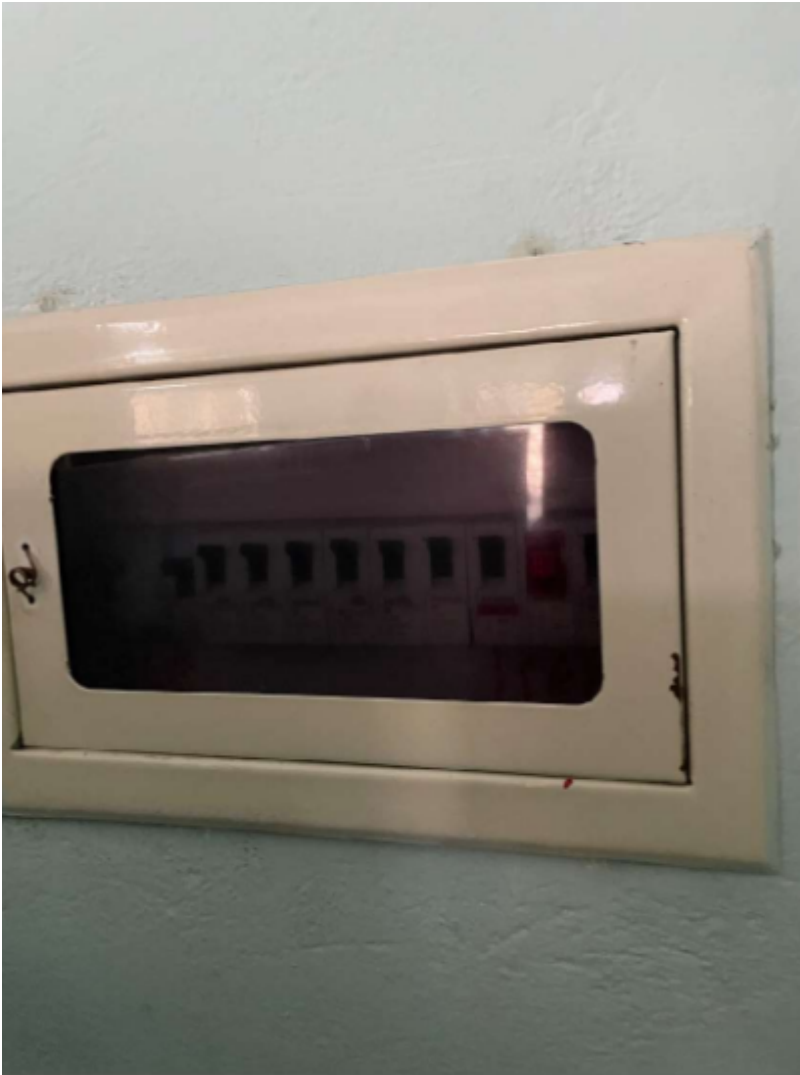
Εικόνα 9(Ηλ.πίνακας δωμάτιο 12 ισογείου)
