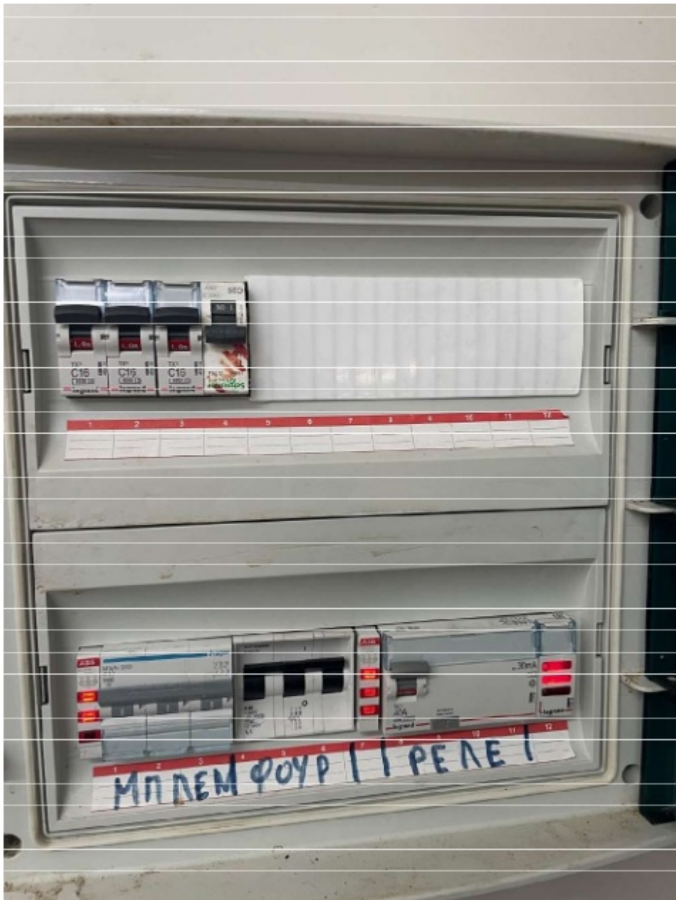
Εικόνα 19(Ηλεκτρικός πίνακας Μαγειρείων χώρος Παρασκευαστήριο)
